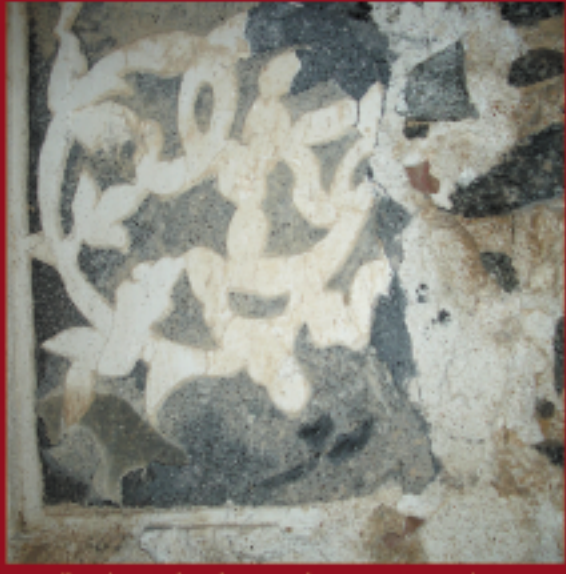
Detalhe de perdas da parte baixa, mostrando alvenaria. Os pontos pretos na argamassa cinza mostram a presença de carvão.
