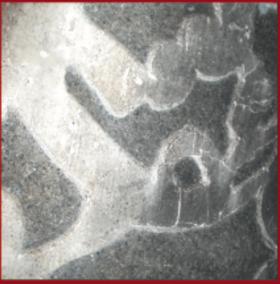
Notar fuligem e fissuras na argamassa decorativa branca.
