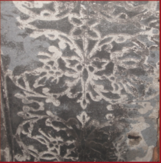
Vista do arco com perda de ornamentação (notar marca de coloração cinza mais claro) e fuligem na parte de baixo (cinza mais escuro). É possível identificar também desgaste superficial da argamassa ornamental branca.
