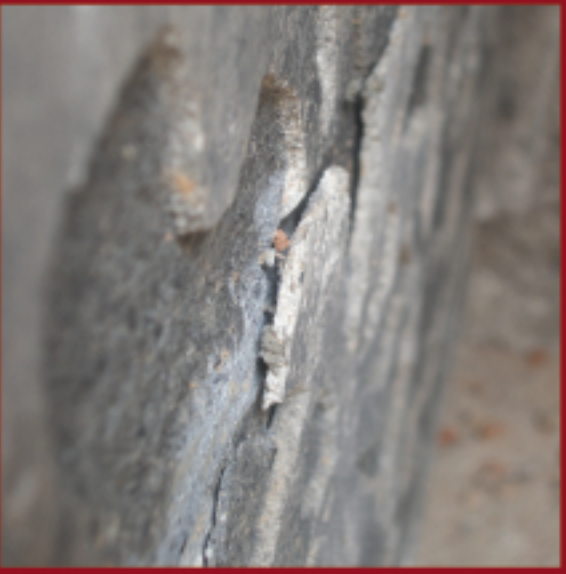
Vista tangencial das argamassas evidenciando o desprendimento da ornamentação do substrato.
