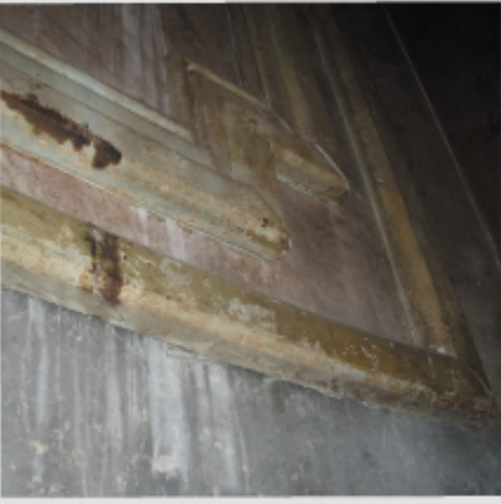
Vista de quina de moldura com manchas diversas, verniz oxidado e escorrimentos provenientes de antigas infiltrações.
