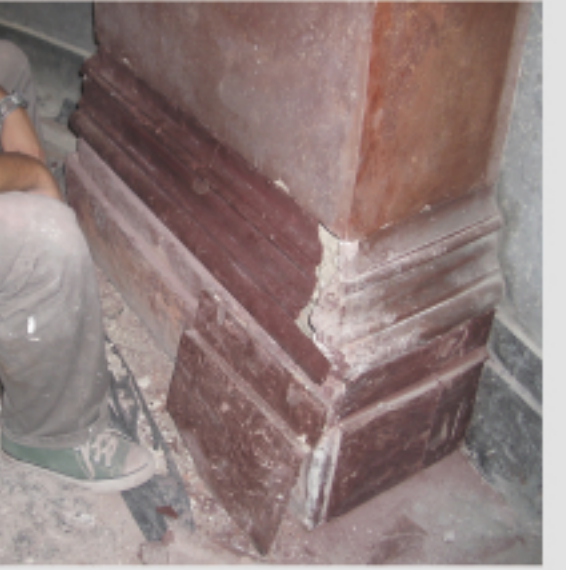
Detalhe de próteses executadas para as bases das colunas. Próximo à quina vertical vemos a prótese da rachadura mostrada em imagem acima.
