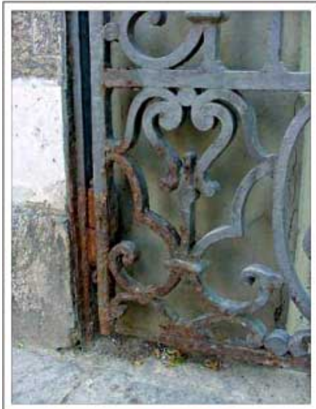
Antes da restauração era assim que se encontrava o portão de ferro forjado do parque
